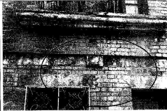
Foto 2. Muro de fachada en regulares condiciones, desprendimientos de unidades de mampostería.
