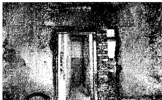
Foto 17. Muros de mampostería de la parte posterior de la edificación. Se observa pérdida de elementos de mampostería y afectación en los dinteles.
