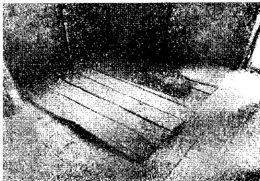
Foto 13. Piso falso colocado por los residentes en la parte posterior de la edificación. Se observa afectación del piso de madera en la habitación localizada hacia la parte oriental de la edificación debido a la falla de elementos estructurales de la placa de entrepiso.
