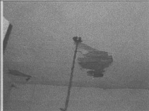
Foto 4. Cielos rasos en mal estado.
