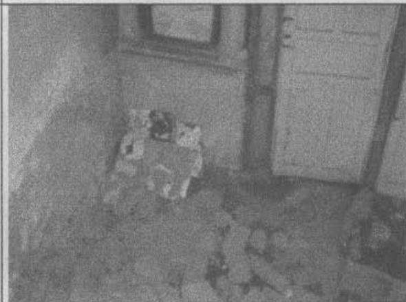
Foto 6. Interior de la edificación el la zona del colapso del muro de fachada..
