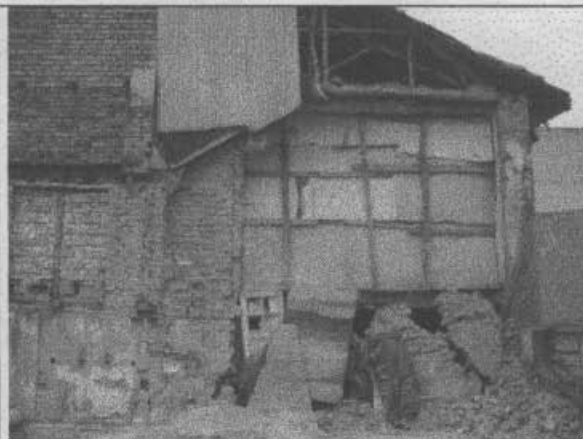
Foto 5. Colapso parcial del extremor Norte del muro de lindero con el predio vecino por el costado Oriental.
