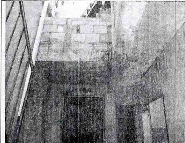
Foto 5. Imagen de la zona posterior de la edificación (primer y segundo nivel), donde se observa un mal estado de conservación de muros y placas de entrepiso.
