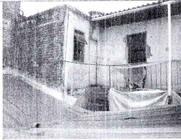
Foto 2. Aspecto general del tercer nivel (zona posterior) de la edificación emplazada en el predio de la Carrera 3 A Bis No. 31 A- 4. Se observa un deterioro alto de esta zona de la edificación.
