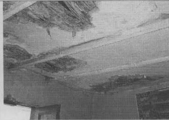
Foto 6. Deterioro y desprendimiento de elementos del cielo raso, ubicado en el sector A del inmueble.
