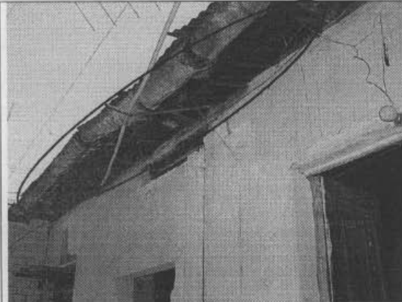
Foto 3. Daños en canaletas y en instalaciones eléctricas ubicadas en el sector A del inmueble.
