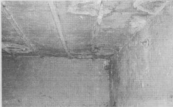
Foto 9. Deterioro en las placas y muros del sector A del inmueble.
