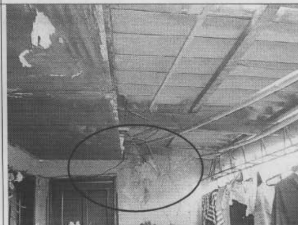
Foto 14. Detalle de entramado de cubierta y humedades en el sector B.
