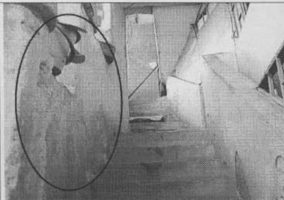
Foto 11. Escaleras de acceso al sector B del inmueble, con desprendimiento de acabados.
