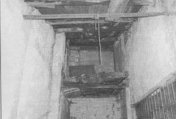
Foto 8. Deterioro progresivo del inmueble.
