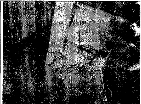
Foto 6. Fractura en los muros de la parte posterior.
