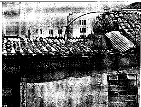
Foto 2. Deterioro en la cubierta del costado norte.
