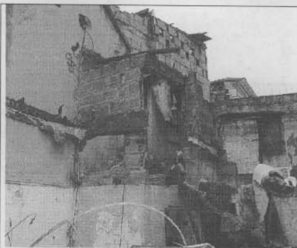
Foto 5. Estructura deteriorada y parcialmente demolida en algunos sectores.
