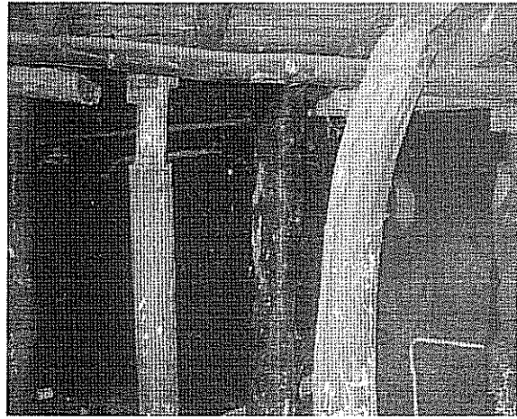
Foto 4. Apoyo del tablado de entrepiso en mal estado.
