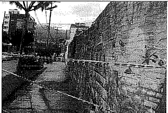
Foto 4. Pérdida de verticalidad en el muro del costado norte.
