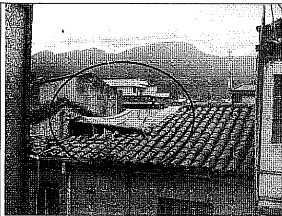
Foto 8. Colapso parcial de la cubierta.
