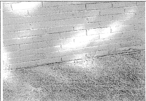
Foto 4. Agrietamiento en la parte inferior del muro, cara interna.
