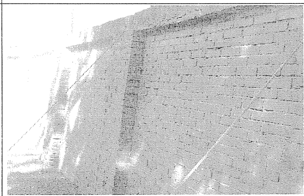
Foto 8. Pérdida de verticalidad en el muro del costado oriental.
