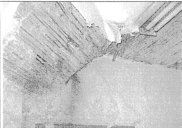
Foto 14. Desprendimientos parciales en cielo raso bajo cubierta del costado nor-occidental.
