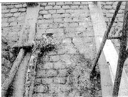
Foto 13. Agrietamiento y fractura del muro en la zona central.
