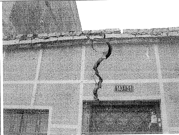
Foto 10. Agrietamiento en dirección vertical con posibilidad de colapso del inmueble de la carrera 111 # 140 A – 51.
