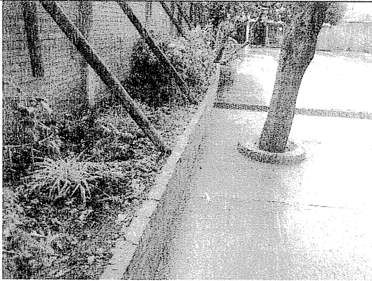
Foto 5. Pérdida de verticalidad de los muros de jardinera.
