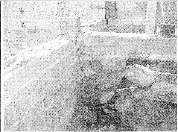
Foto 10. Enchape de muro de baños desprendido.
