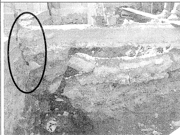
Foto 7. Desprendimiento y daño en cimentación.
