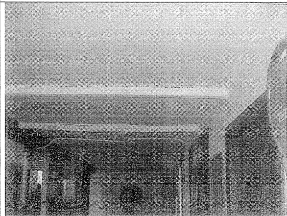
Foto 6. Cielo raso bajo entepiso en buen estado.
