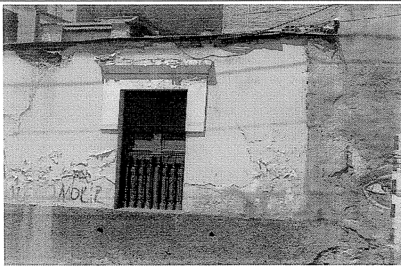
Foto 3. Deterioro de acabados.
