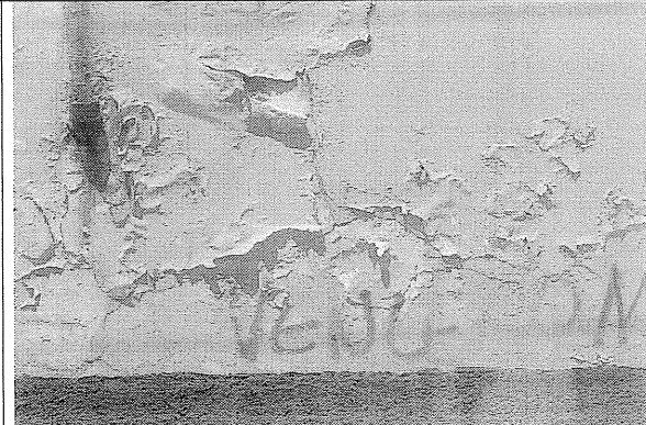
Foto 4. Fisuras y desprendimientos de acabados.
