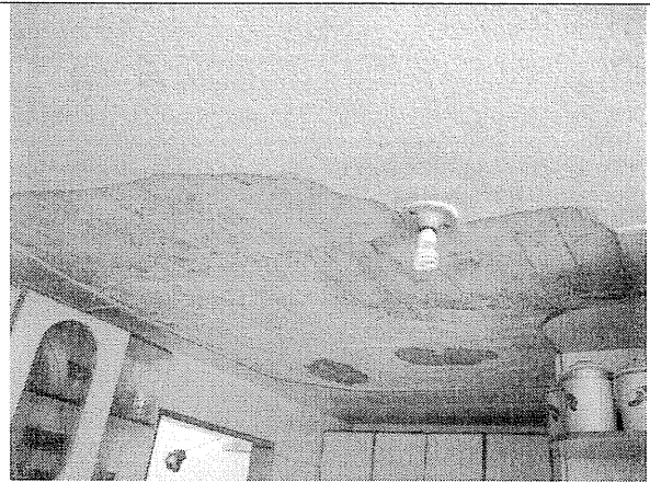
Foto 11. Placa sin daño estructural, caída del pañete.
