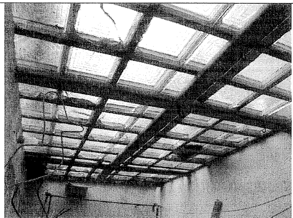
Foto 13. Claraboya en bloques de vidrio, sin daño.
