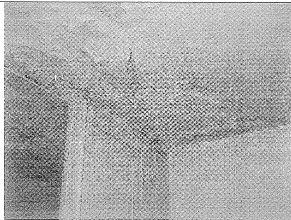
Foto 9. Humedad bajo la placa de cubierta.
