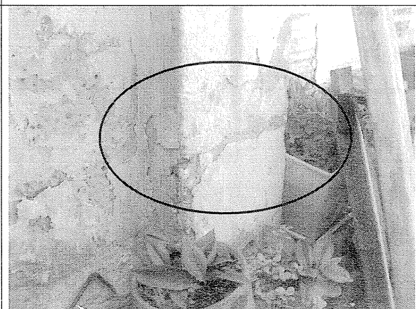
Foto 8. Fisuras en muro de lindero del costado norte.
