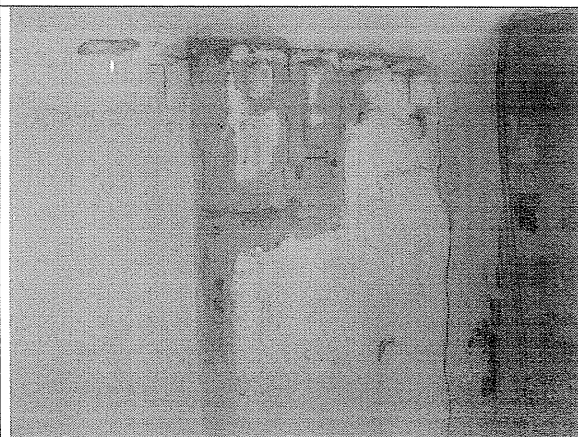
Foto 7. Deterioro en acabados de muro de lindero del costado norte.
