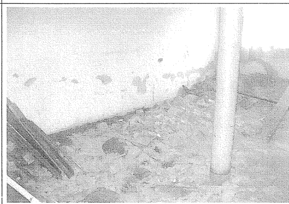
Foto 6. Fisuras y deterioro en acabados de muros del primer piso.
