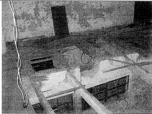
Foto 9. Colapso parcial del entrepiso.
