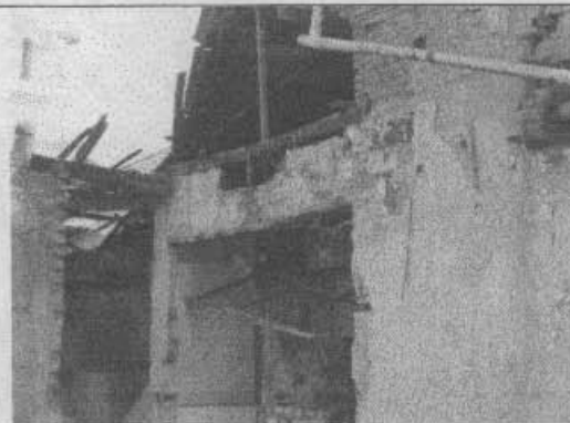
Foto 5. Colapso parcial en la parte posterior de la edificación.
