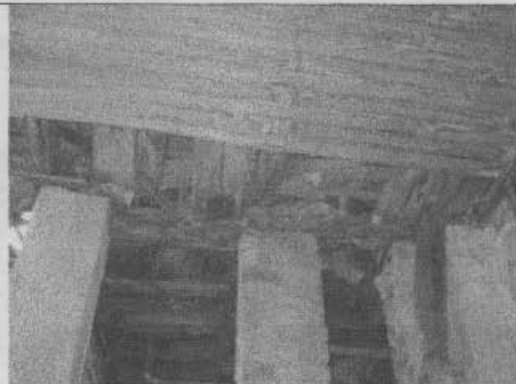
Foto 10. Daños en el entrepiso.
