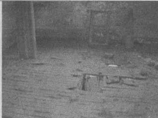
Foto 9. Daños en el entrepiso.
