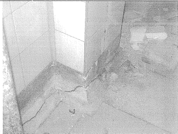
Foto 8. Grietas en la base de los muros.
