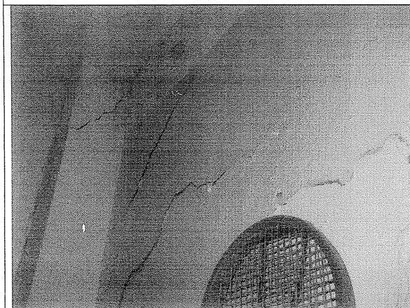
Foto 5. Muros del costado norte en mal estado.
