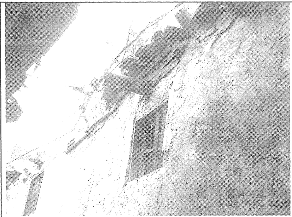
Foto 8. Desprendimientos de tejas de barro de la parte superior del muro del costado sur.
