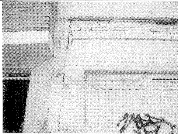
Foto 3. Fisuras en el extremo sur del muro de fachada.
