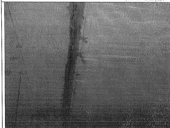
Foto 7. Abertura en junta de construcción.
