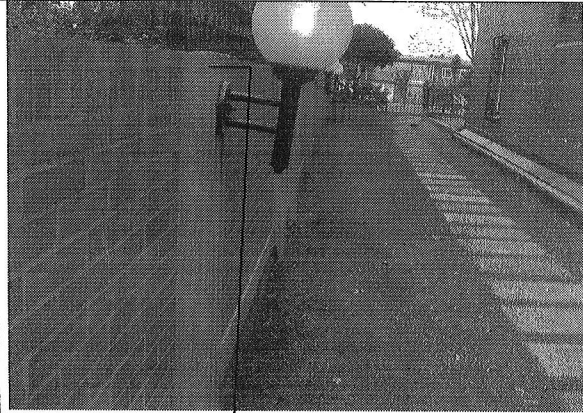
Foto 3. Pérdida de verticalidad del muro de cerramiento.
