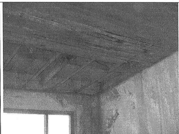
Foto 10. Deterioro en cielo raso bajo la cubierta.
