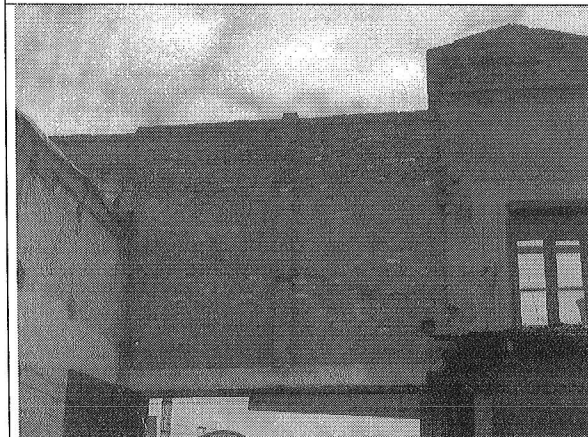
Foto 5. Parte superior del muro de fachada suelto.
