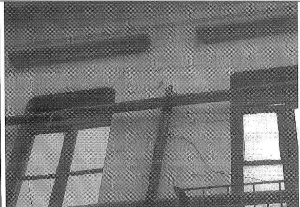
Foto 4. Agrietamientos en la parte superior del muro de fachada.
