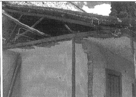
Foto 7. Deterioro en la cubierta de la construcción de la zona posterior.
