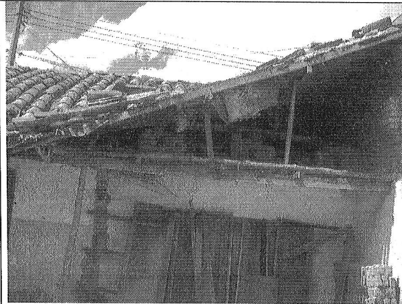
Foto 9. Cubierta en malas condiciones.
