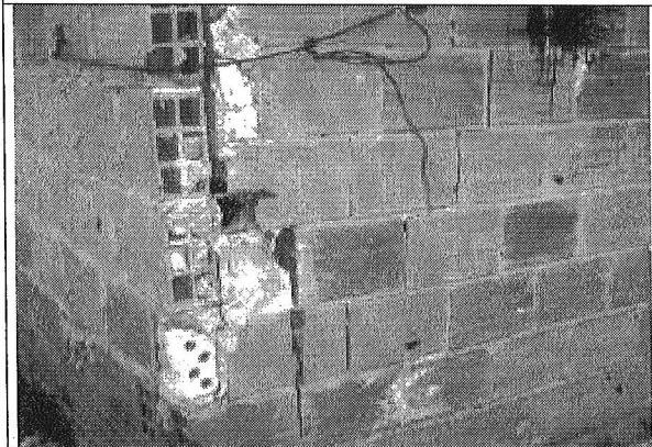
Foto 5. Agrietamientos en la esquina sur-oriental del muro.
