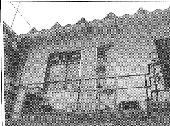
Foto 7. Muros del sector posterior agrietados.
