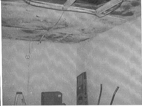
Foto 18. Deterioro del cielo raso por ingreso de agua.
