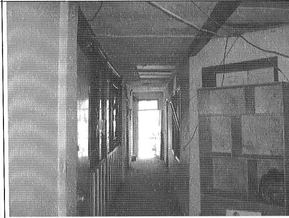
Foto 6. Interior del segundo piso, deformaciones.
