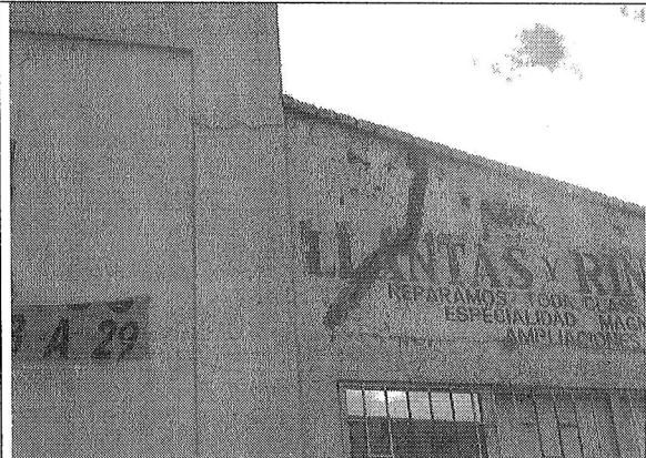
Foto 4. Fisuras y grietas en el muro del costado norte.
