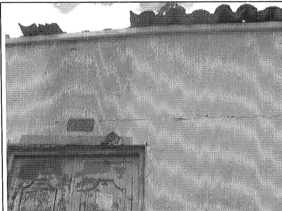
Foto 6. Detalle del agrietamiento de sentido horizontal.
