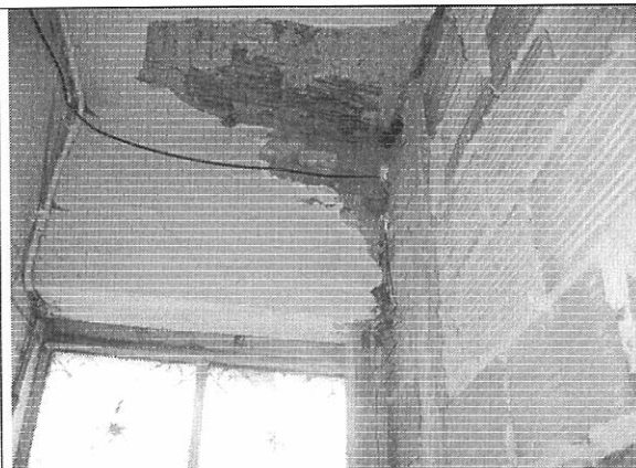
Foto 7. Columneta y daños en el cielo raso.
