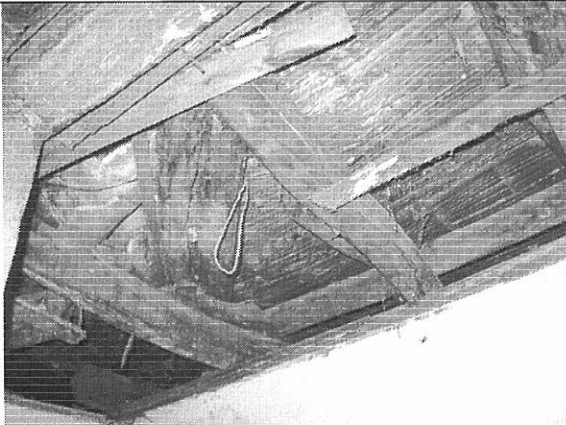
Foto 5. Daños en la estructura de cubierta.
