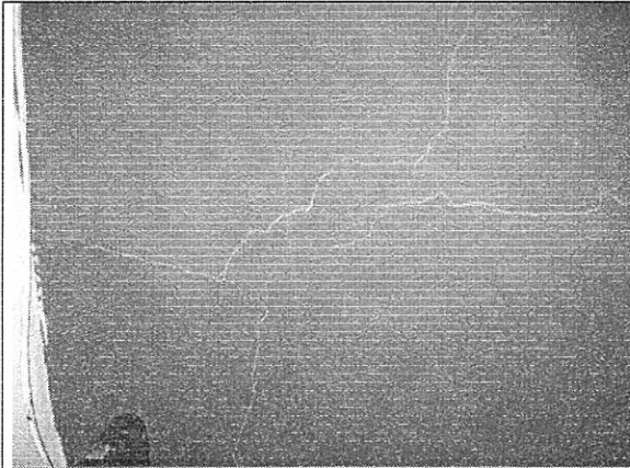
Foto 9. Fisuras en muros del sector frontal.
