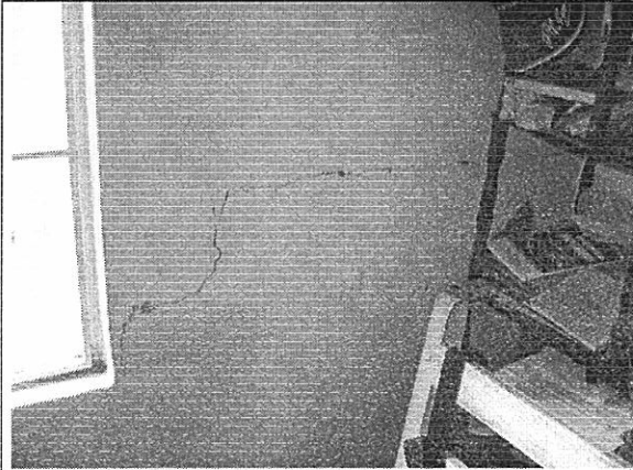
Foto 3. Agrietamiento en la cara interna de la fachada.
