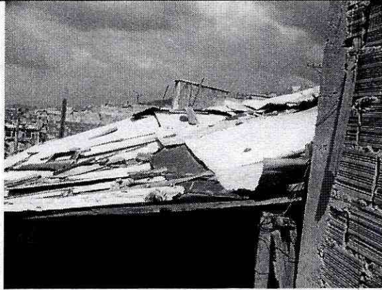
Foto 5. Falta de amarre adecuado de las tejas.
