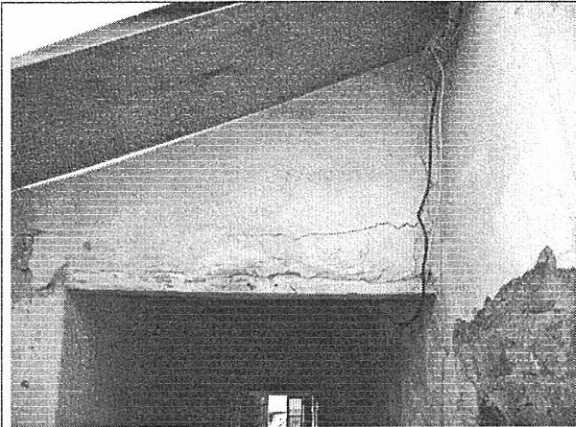
Foto 9. Daños en muros perpendiculares al de lindero.
