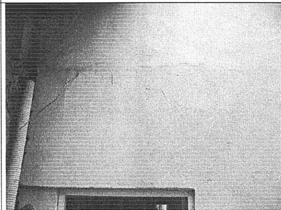
Foto 8. Agrietamiento en muro perpendicular al de lindero.
