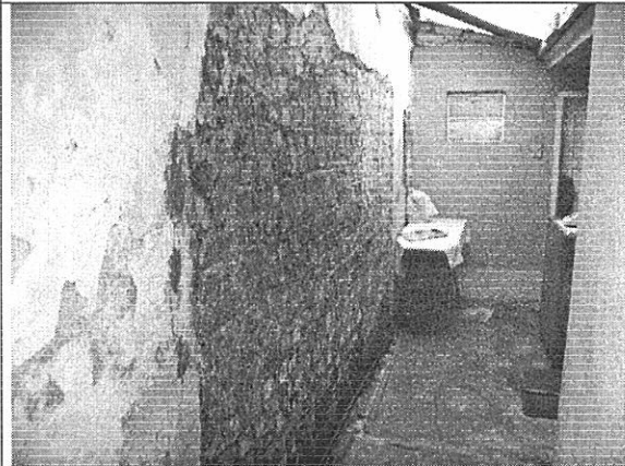
Foto 6. Deterioro en muro de lindero del costado sur.
