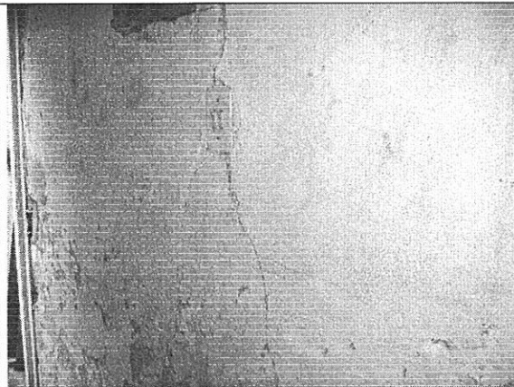
Foto 5. Agrietamientos en muro de lindero del costado sur.
