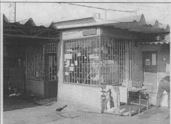
Foto 4. Costado interior sur-occidental del inmueble, sin daños estructurales que evidencien mal comportamiento.
