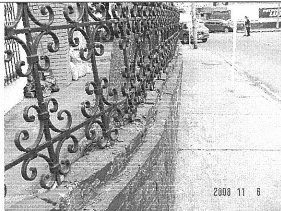
Foto 5. Deformación evidente del muro sobre la Carrera 8
