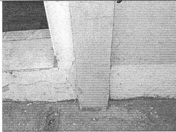
Foto 3. Fisuras en los muros de fachada
