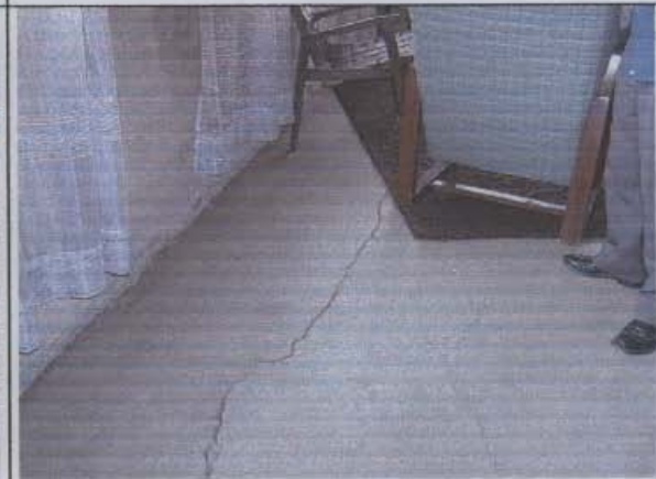
Foto 4. Vista interna de segundo piso, en el sector del voladizo agrietado.
