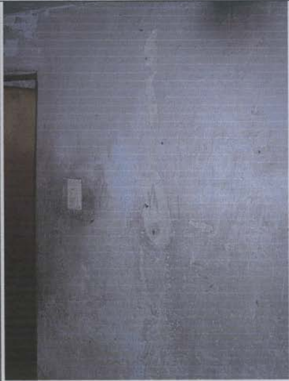
Foto 6. Vista interna del primer piso, sin daños estructurales que evidencien mal comportamiento. Hay desprendimiento y deterioro de los acabados.
