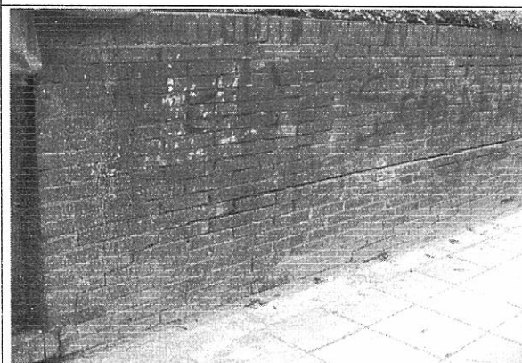
Foto 3. Agrietamiento en la parte inferior, muro sobre la carrera 13
