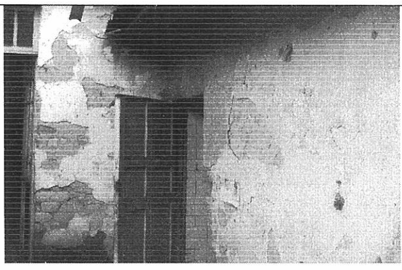
Foto 6. Muros de la parte posterior en mal estado
