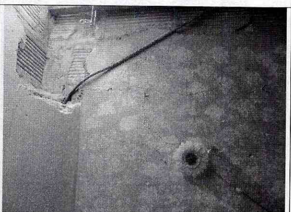
Foto 8. Grietas en muros posteriores de segundo piso
