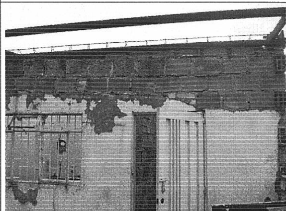
Foto 14. Deterioro progresivo en muros de altillo
