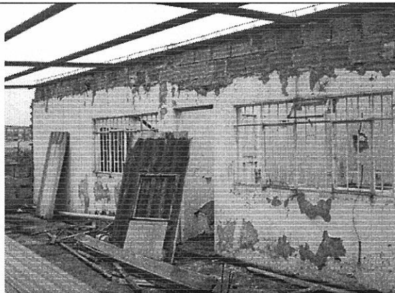
Foto 13. Muros de altillo sin cubierta con deterioro
